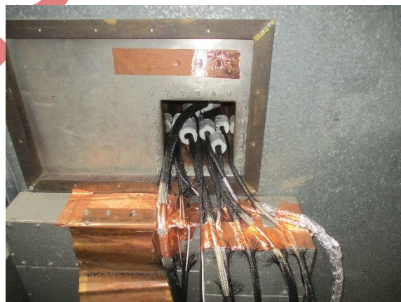
Découplage des câbles entrants dans la chambre anéchoïque
